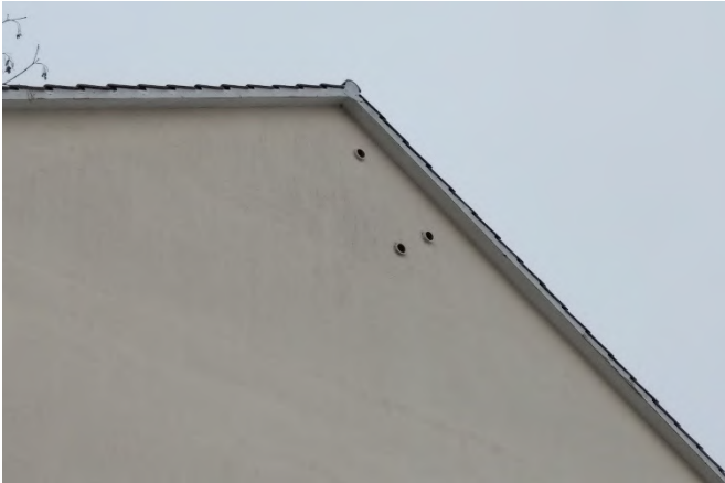
Abbildung 5 Lüftungslöcher an den Giebelseiten der Bestandsgebäude, Foto: W+G vom 14.01.2021.
